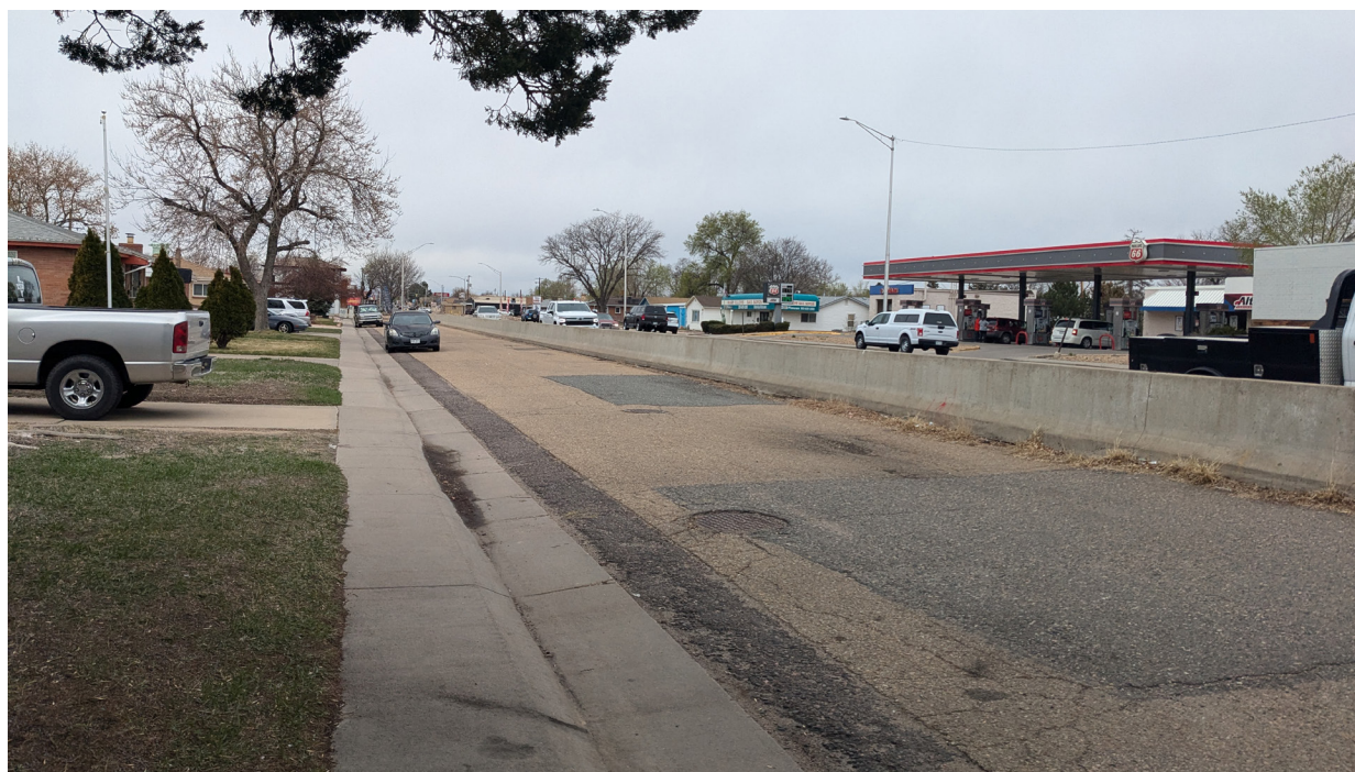
Figura 6. Condiciones Deficientes y Faltantes de Aceras a lo Largo de Bridge Street
